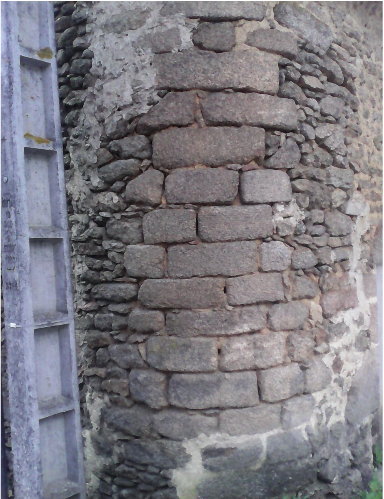
Fromental , hameau de Montjourde. Magnifique appareillage de pierres arrondies gâché par le poteau en ciment armé.
